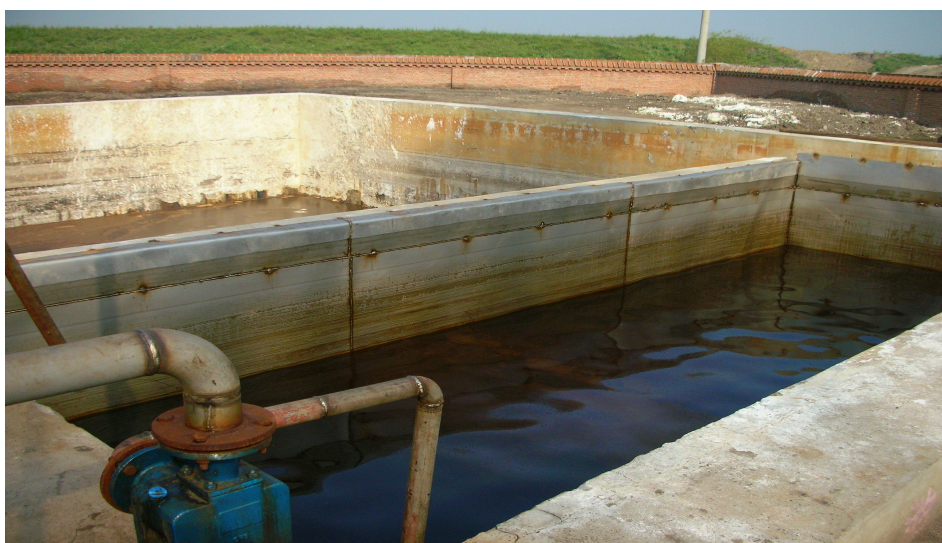
图 4-3 材质为白钢的工艺废水收集池
